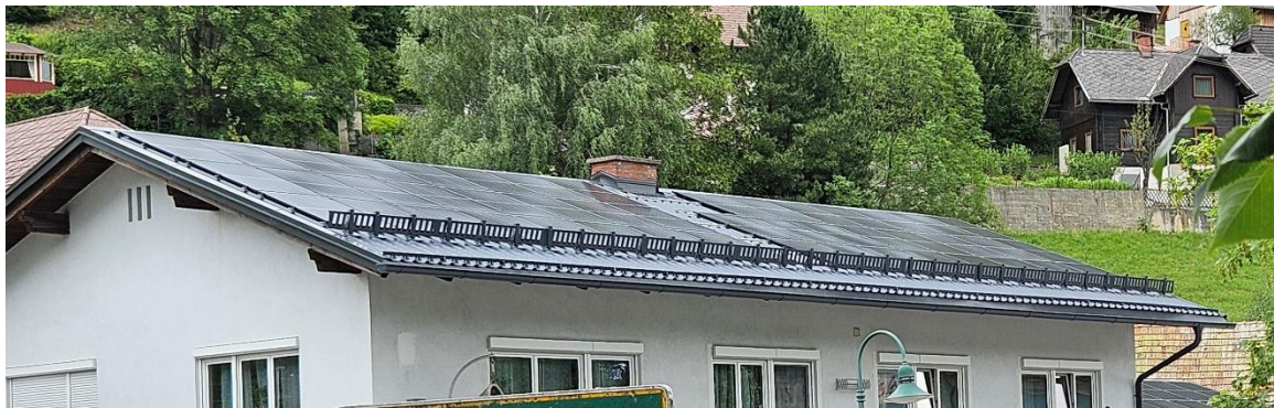
Abbildung 1: Photovoltaikanlage am kommunalen Gebäude © Gemeinde St. Kathrein am Hauenstein
