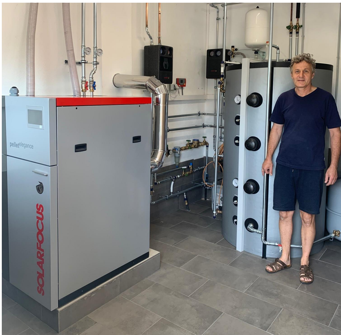
Abbildung 2: Neuer Pelletskessel und Pufferspeicher mit zufriedenen Kunden: Robert Totz © Andreas Totz
