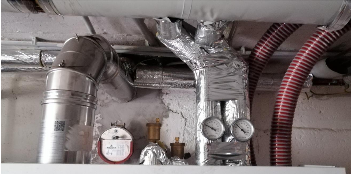
Abbildung 5: Saugrohr und gedämmte Leitungen © Diözese Graz-Seckau - Katholische Kirche Steiermark
