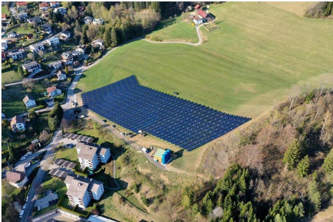
Abbildung 1: Luftbild der thermischen Großsolaranlage © SOLID Solar Energy Systems GmbH
